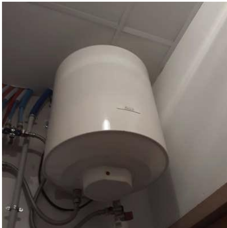
Ballon électrique de 100 L
