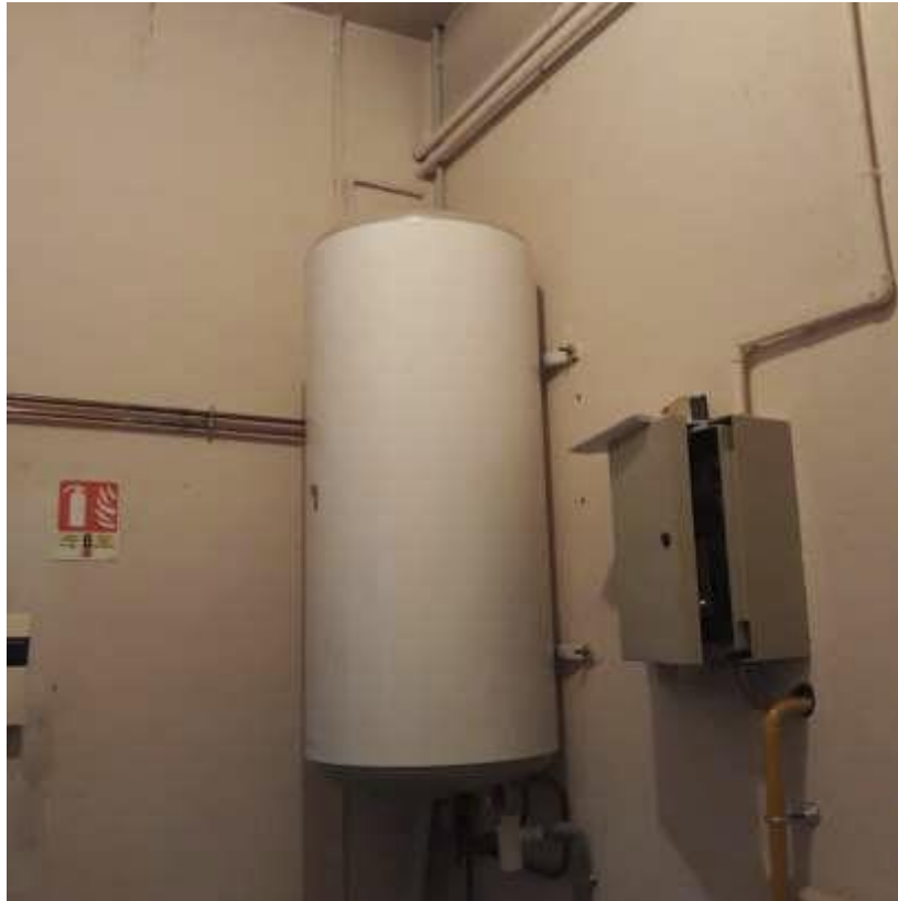
Ballon électrique de 200 L
